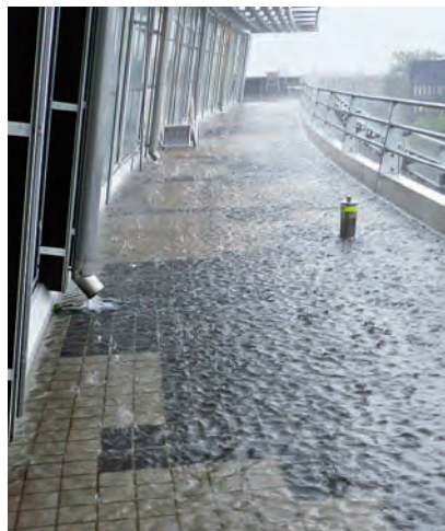
Als Folge von kurzzeitigem Wassereinstau bei Starkregen auf Flachdächern und Balkonen kann das
