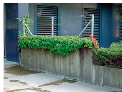
Diese Mauer schützt den untenliegenden Lichthof vor Oberflächenwasser einer Zufahrt.
