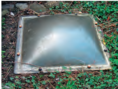
Falsch: Die Lichtkuppel ist ebenerdig eingebaut
