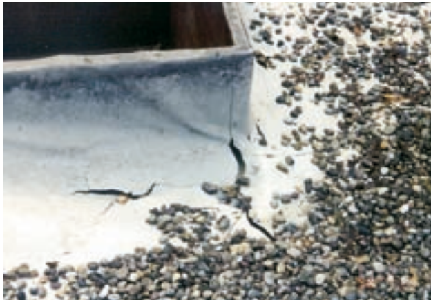
Abbildung 6.13: gealterte Dichtungsbahn, Foto GVL.
