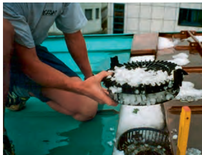
Beispiel einer verstopften Dachentwässerung infolge grosser Hagelkornakkumulation.
