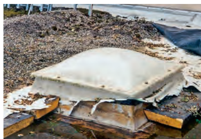
Durch Hagelschlag perforierte freiliegende Abschlüsse von Kunststoff-Dichtungsbahnen.
