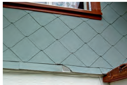
Absplinterung von Faserzementplatten
