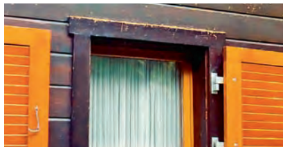
Strukturschaden durch Abschlagen von exponierten Kanten
