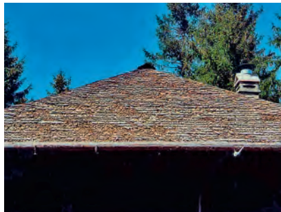
Strukturschaden an Holzschindeln
