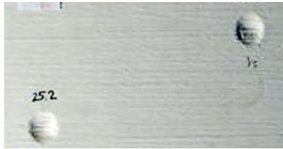
Dellen Abschlagen des Farbanstrichs
