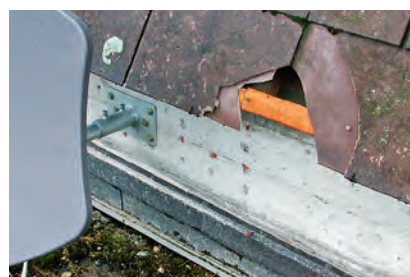
Absplinterung von Faserzementplatten
