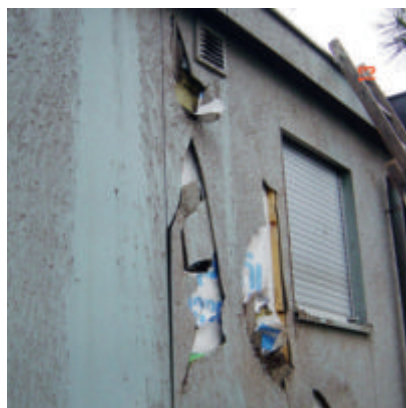
Faserzement-Wellplatten stecken. Diese Bilder zeigen, dass der Domino-Effekt auch für Menschen sehr gefährlich sein kann.
