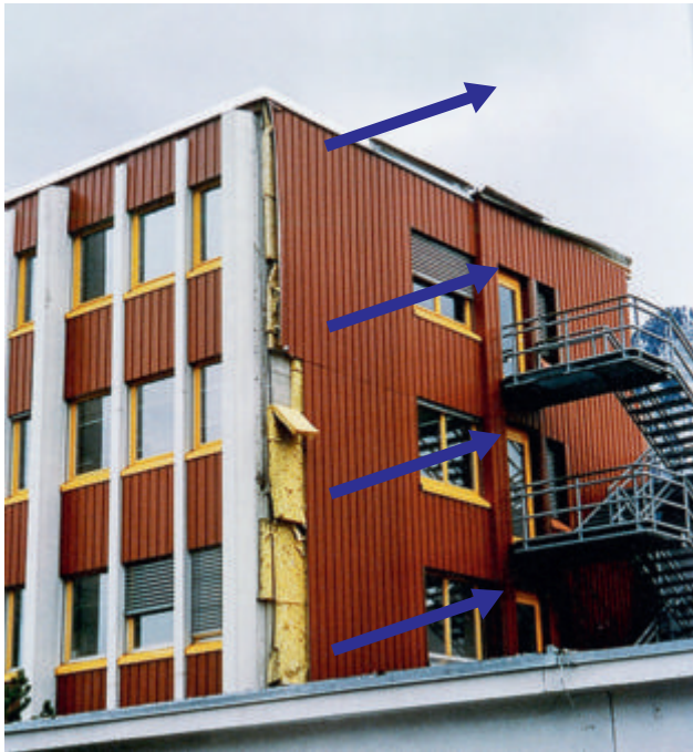
Sturmschäden an einer Fassade im Bereich der Gebäudekante als Folge von Druckwirkung innerhalb der Fassade (nicht eingezeichnet) und Sogwirkung (blaue Pfeile). Bild: Gebäudeversicherungsanstalt des Kantons St. Gallen
