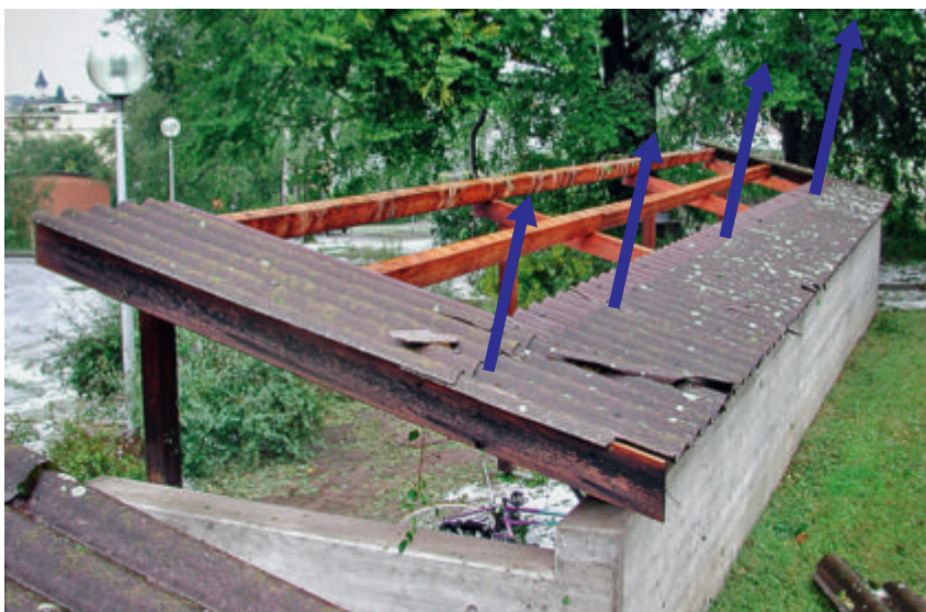
Wie bei den Vordächern kann es auch bei Unterständen zu massiven Schäden kommen, wenn die Sogwirkung von oben und die Druckwirkung von unten gemeinsam in die gleiche Richtung wirken. Bild: Aargauische Gebäudeversicherung
