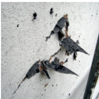
Nahaufnahmen von beschädigten Gebäude-Fassaden. Das Bild links zeigt eine Fassade, in welcher Bruchstücke von losgerissenen
