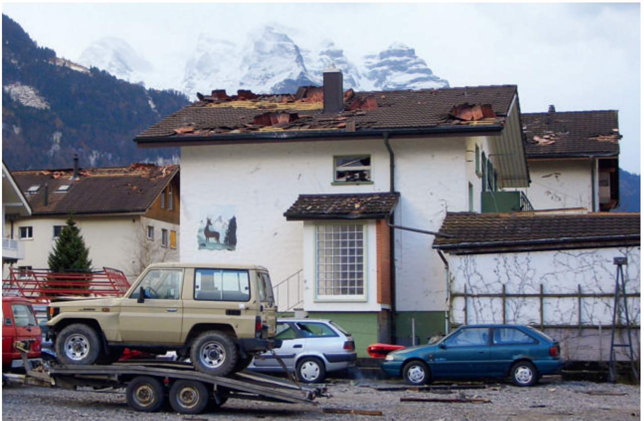
Klassisches Schadenbild eines Kollektivschadens: mehrere beschädigte Gebäude in Dallenwil NW (12. März 2008; siehe auch Seite 45). Bild: Nidwaldner Sachversicherung
