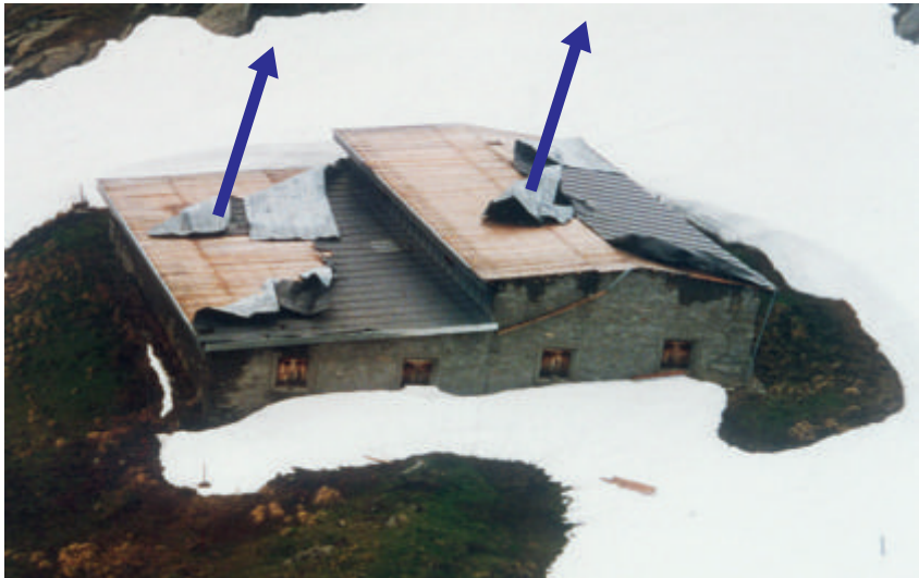
Ein Blechfalzdach, von Sturmböen zerfetzt. Bild: Gebäudeversicherung Graubünden
