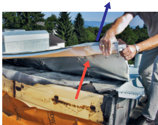
Tages von einer Sturmböe erfasst wurde, waren die Sogkräfte genügend stark, um die Nägel auszureissen. Quelle: [09]. Bilder: Aargauische Gebäudeversicherung
