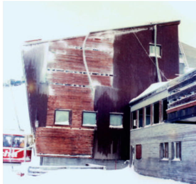
Sturmschäden an der Fassade einer Luftseilbahn-Bergstation. Bild: Gebäudeversicherung Graubünden
