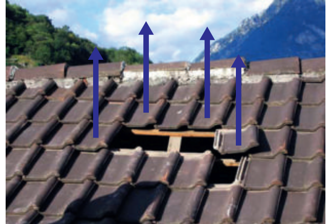
Die Sogwirkung wird häufig unterschätzt; dementsprechend oft führt sie zu Schäden. Bild: Gebäudeversicherung Graubünden
