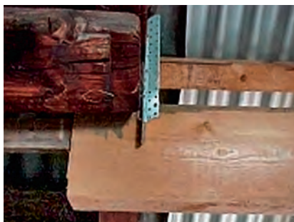
Umbau mit ungenügend bemessenen Verbindungsmitteln.
