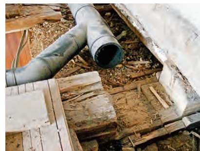
Schwächung des Tragwerks durch entfernten Balken.
