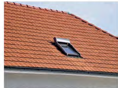
Beispiel einer beschädigten Dachaufbaute (Storenkasten) infolge von Schneerutscheinwirkung.
