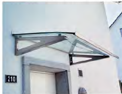
Beispiel eines gebrochenen Vordaches infolge Schneerutschs vom Dach.
