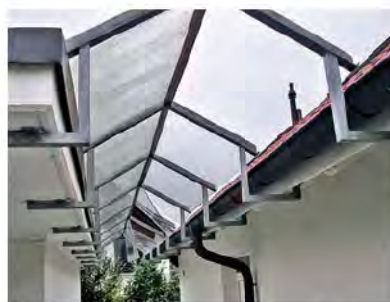
Beispiel eines beschädigten Zwischendaches infolge von Schneerutsch vom Hauptdach.
